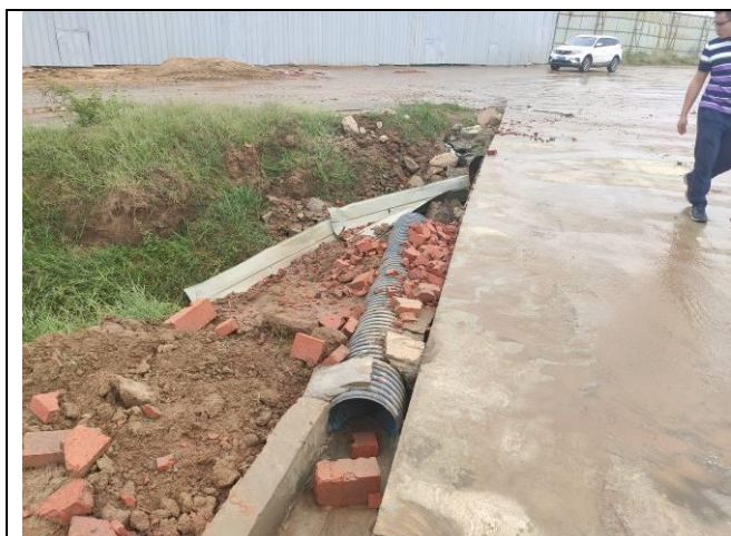
说明：排水去向存在问题，散排至道路后，影响道路安全
