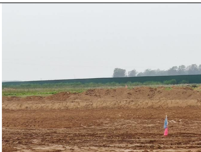
说明：梁厂剥离表土，未及时转运
