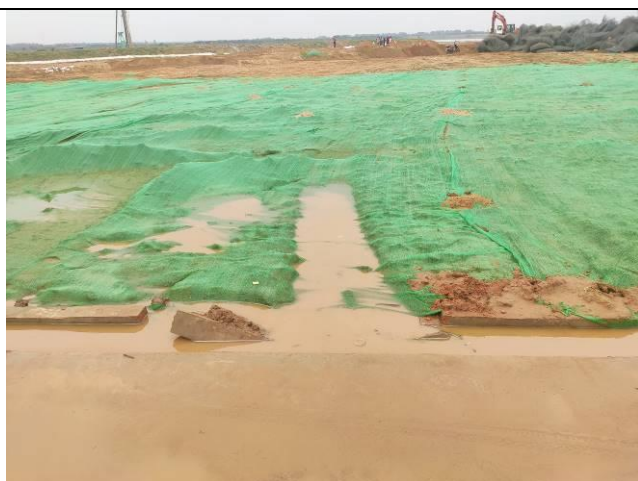
说明：排水沟损毁
