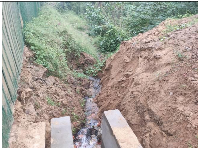
说明：排水沟末端无消力、沉沙措施
