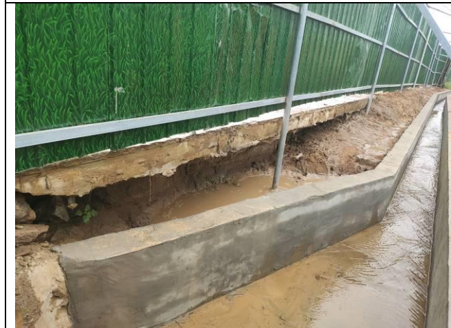
说明：场地内无序排水，影响道路安全
