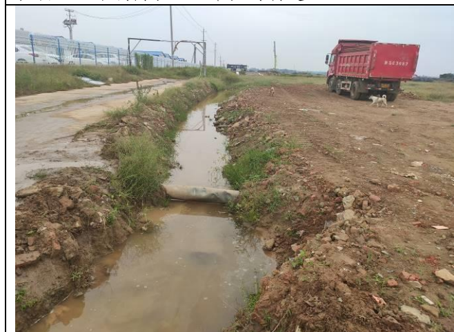
说明：排水沟长度不够，且排水去向不明
